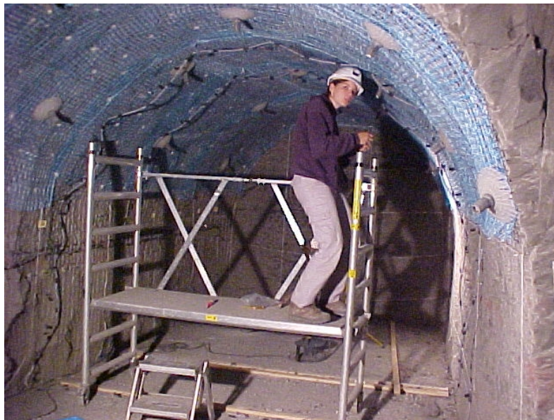
Abb.1: Die Versuchsstrecke und Installation der Ringprofile 1 und 2
